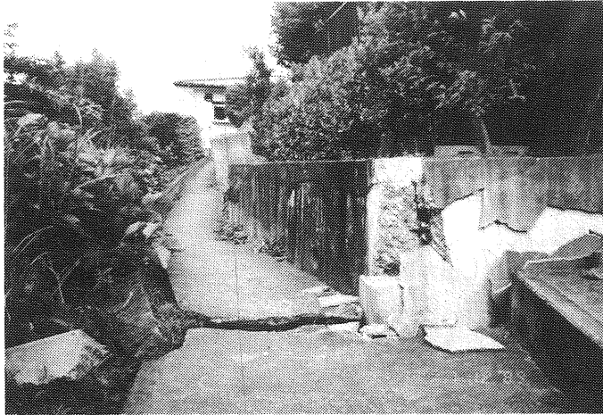
写真1 7月9日M5.5地震被害（撮影平野）
