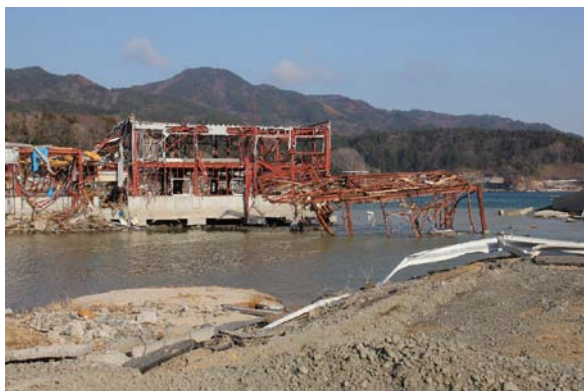
写真10 船越湾山田のトンボロ南側部分の被災状況
