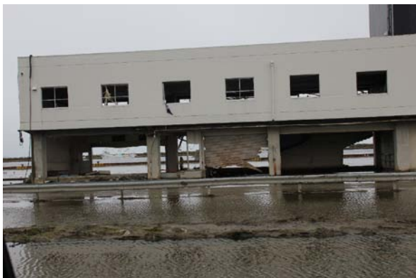
写真13 石巻漁港の被災状況（沈下状況）
