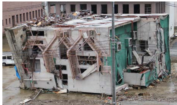
写真9 町中心部の津波で倒壊した建物
