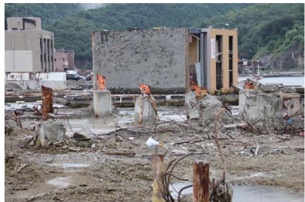
写真10 津波で倒壊した建物とコンクリート基礎の被災状況
