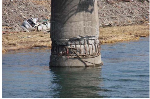
写真4 釜石市甲子川の橋脚の地震による被災で座屈防止用の巻き鉄筋が現れている
