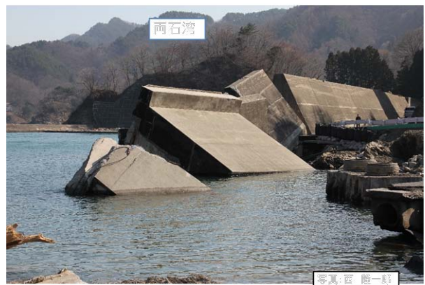
写真5 両石湾の津波堤防の被災状況で、堤防が倒壊し、背後地に洗掘が生じている
