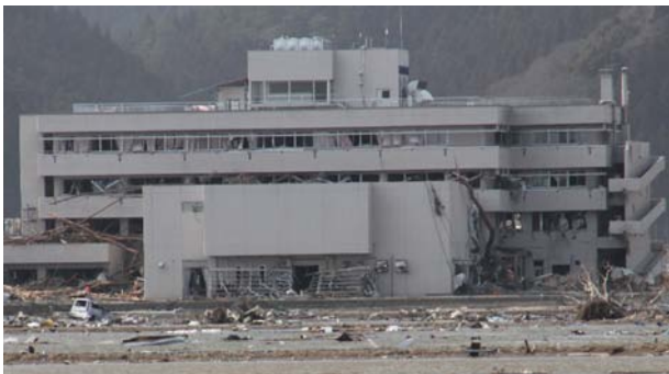
写真 14 陸前高田市の高田病院の被災状況 (4階部分も被災)
