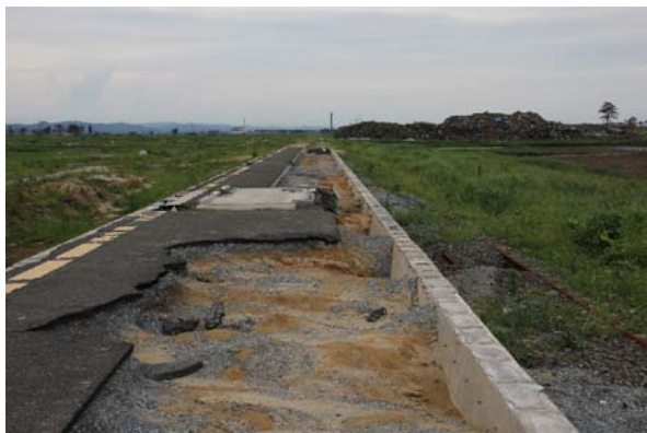
写真7 山下駅のプラットフォームと線路の被災状況
