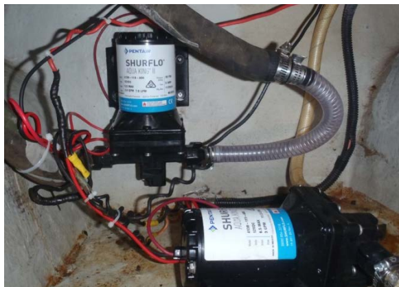
上は排水ポンプ、下は給水ポンプ各々取替交換工事を依頼した
